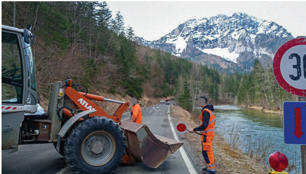
Abb. 9: Die Hochschwab Straße (B 24) zwischen den Straßenkilometern 25,05 und 25,20 östlich von Gschöder im Gemeindegebiet von Mariazell (Bundesland Steiermark) während der Felsräumungsarbeiten nach dem Steinschlag am oder vor dem 23. März 2023 (© Foto: Fachabteilung Straßenerhaltungsdienst (STED) des Landes Steiermark; Quelle: Facebook-Seite des Straßenerhaltungsdienstes (STED) des Landes Steiermark) [1].
