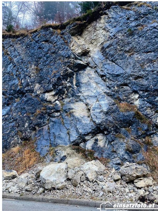
Abb. 13: Felssturzareal vom Abend des 25. November 2022 an der Aschauerstraße unweit des Straßenkilometers 6,8 im Raum Burgstall im Gemeindegebiet von Brandenburg (Bundesland Tirol) (© Foto: „ZOOM.TIROL“; Quelle: Webseite von „einsatzfoto.at“) [1].
