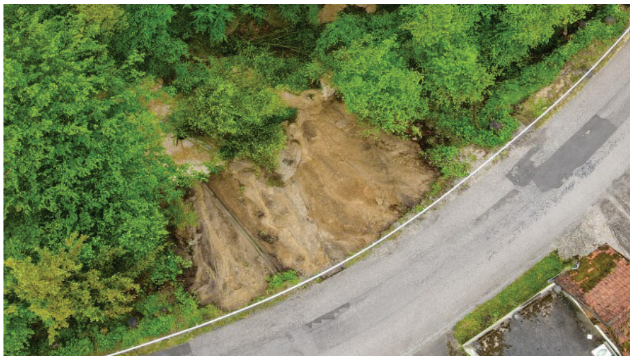
Abb. 16: Hangrutschung am 13. Mai 2022 an der Gilgenberger Straße (L 1001) auf Höhe des Straßenkilometers 2,66 im Gemeindegebiet von Schwand (Bundesland Oberösterreich) (© Foto: Daniel Scharinger/Pressefoto Daniel Scharinger; Quellen: Facebook-Seite von „Pressefoto Daniel Scharinger“ [12] und Webseite von „laumat.at media“ [13]).
