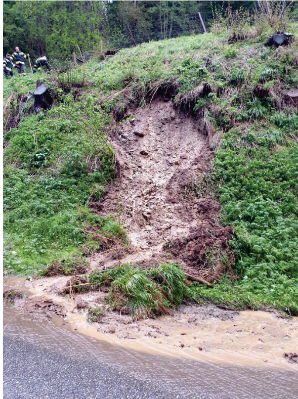
Abb. 12: Eine der beiden Böschungsrutschungen vom 12. Mai 2022 am Sonnbergweg auf der orografisch linken Talseite der Mur im Gemeindegebiet von Stadl-Predlitz (Bundesland Steiermark) (© Foto: Freiwillige Feuerwehr Stadl an der Mur; Quelle: Webseite der Freiwilligen Feuerwehr Stadl an der Mur) [9].
