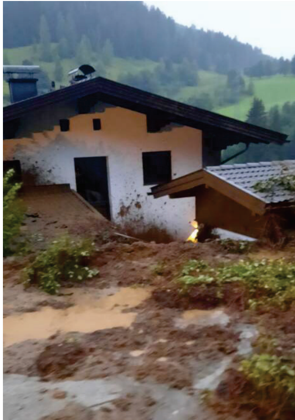
Abb. 52: Durch eine Hangmure am Abend des 31. Juli 2021 in Mitleidenschaft gezogene Gebäude an der Gemeindestraße Pichl-Stein im Ortsteil Stein der Gemeinde Sankt Veit im Pongau (Bundesland Salzburg) (© Foto: Freiwillige Feuerwehr Schwarzach im Pongau; Quelle: Webseite der Freiwilligen Feuerwehr Schwarzach im Pongau) [88].
