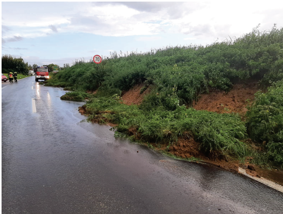
Abb. 50: Böschungsrutschungen am Abend des 27. Juli 2021 an der Kremstalstraße (B 139) auf Höhe des Straßenkilometers 17,7 im Gemeindegebiet von Ansfelden (Bundesland Oberösterreich) nahe der Zufahrt zum Schloss Weißenberg (© Foto: Freiwillige Feuerwehr Weißenberg; Quelle: Webseite der Freiwilligen Feuerwehr Weißenberg) [83].
