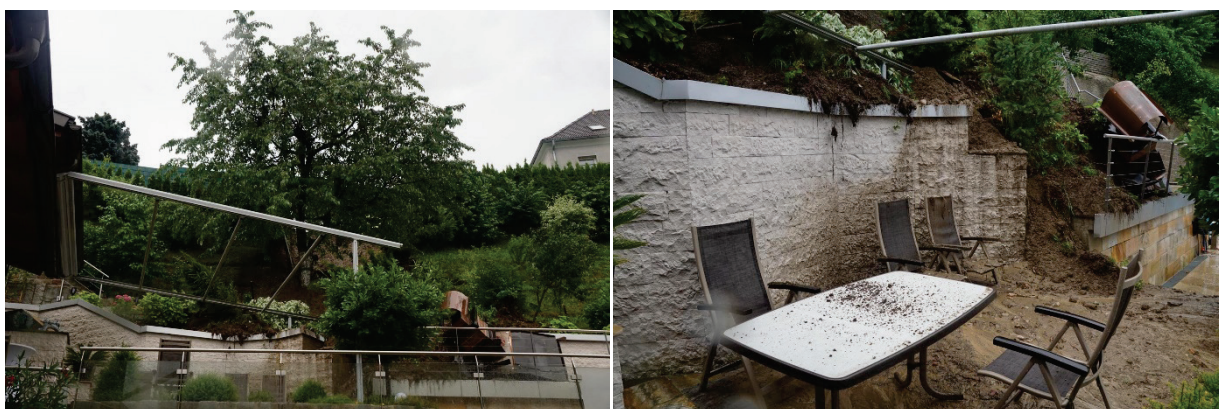
Abb. 41: Areal der Hangrutschung vom 18. Juli 2021 zwischen Fischhubweg und Kellaugasse in der Stadtgemeinde Steyr (Bundesland Oberösterreich) (© Fotos: Freiwillige Feuerwehr Steyr; Quelle: Webseite der Freiwilligen Feuerwehr Steyr) [70].
