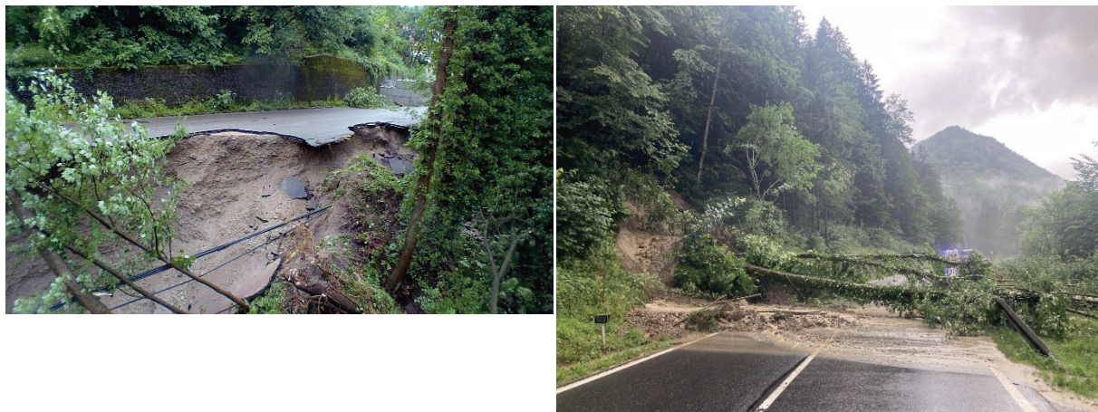
Abb. 46: Böschungsbruch vom 18. Juli 2021 an der Zufahrtsstraße zum EVN-Kleinwasserkraftwerk Dorfmühle in Dorf in der Gemeinde Allhartsberg (Bundesland Niederösterreich) (linkes Bild; © Foto: Freiwillige Feuerwehr Allhartsberg; Quelle: Webseite der Freiwilligen Feuerwehr Allhartsberg [77]) und Hangrutschung mit entwurzelten Bäumen vom 18. Juli 2021 an der Ybbstal Straße (B 31) bei Straßenkilometer 10,0 auf Höhe des Bootshauses zwischen Opponitz und Waidhofen an der Ybbs im Gemeindegebiet von Opponitz (Bundesland Niederösterreich) (rechtes Bild; © Foto: Freiwillige Feuerwehr Opponitz; Quelle: Webseite der Freiwilligen Feuerwehr Opponitz [78]).
