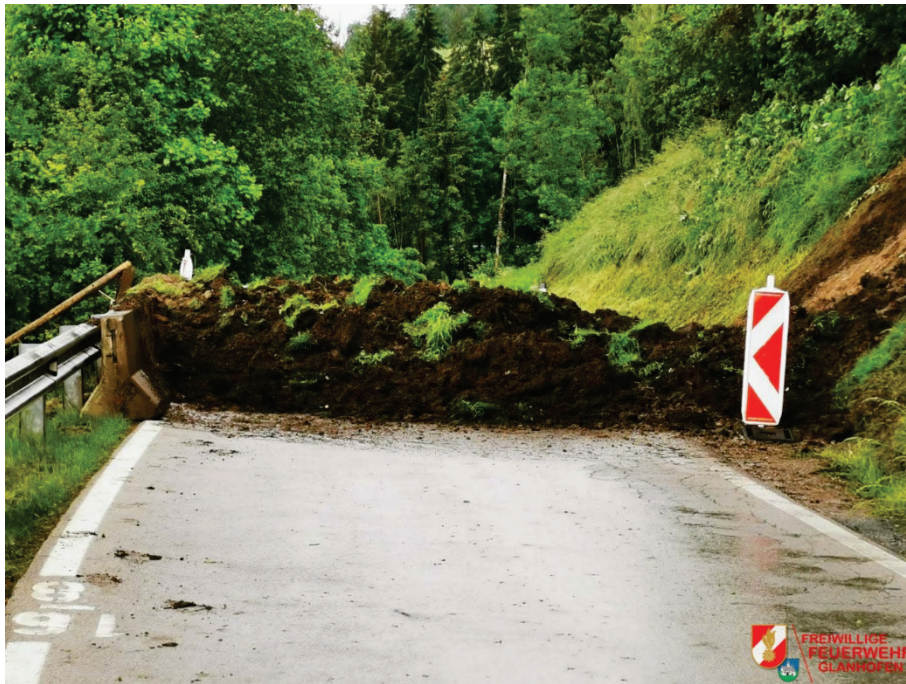
Abb. 24: Rutschmasse vom 7. Juni 2021 auf der Ossiacher Tauern Straße (L 47) auf Höhe des Straßenkilometers 16,8 südwestlich von Sankt Nikolai im Gemeindegebiet von Feldkirchen in Kärnten (Bundesland Kärnten) (© Foto: Freiwillige Feuerwehr Glanhofen; Quelle: Webseite der Freiwilligen Feuerwehr Glanhofen) [30].
