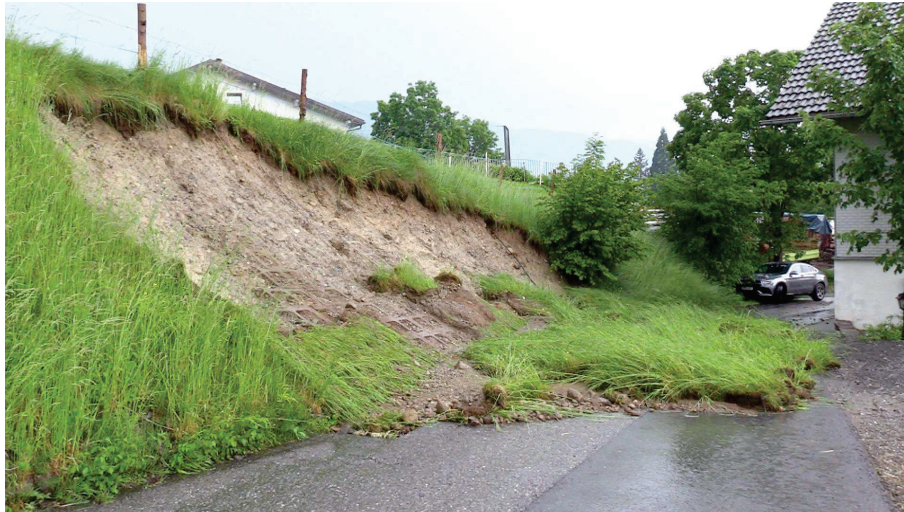
Abb. 28: Böschungsrutschung am 9. Juni 2021 an einer Gemeindestraße in Hof unweit des Zentrums von Lingenau in der gleichnamigen Gemeinde (Bundesland Vorarlberg) (© Foto: Maurice Shourot; Quelle: ORF-online) [37].
