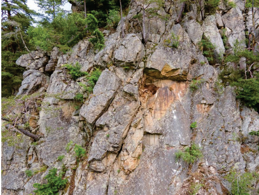
Abb. 26: Ausbruchstelle des Felssturzes vom 7. Juni 2021 auf den Donauradweg R 1 im Gemeindegebiet von Hartkirchen zwischen Kobling und Kaiserau (Bundesland Oberösterreich) (© Foto: viadonau; Quelle: Webseite von viadonau) [36].
