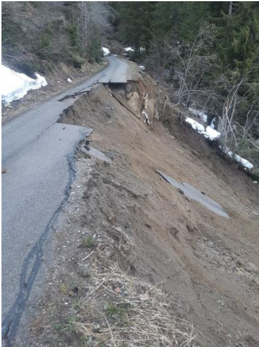
Abb. 14: Schwer beschädigter Penzelberger Güterweg mit der Abrisskante der Hangrutschung auf der orografisch rechten Seite des Mühlbaches am Penzelberg in der Gemeinde Winklern (Bundesland Kärnten) nach der Nachrutschung am Abend des 2. Mai 2021 (© Foto: Stützpunkt-Feuerwehr Winklern; Quelle: „Kleine Zeitung“-online) [1].
