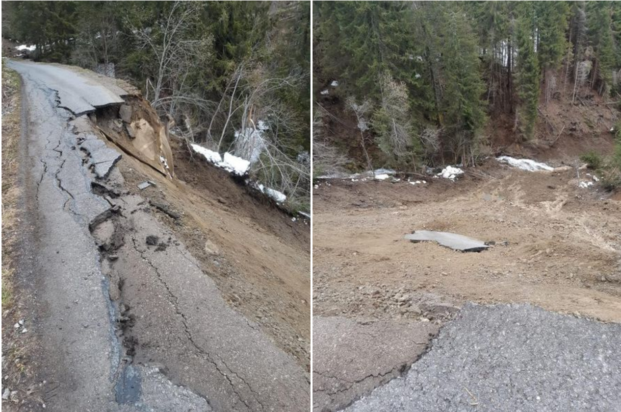
Abb. 13: Schwer beschädigter Penzelberger Güterweg (linkes Bild) und Areal der Hangrutschung (rechtes Bild) auf der orografisch rechten Seite des Mühlbaches am Penzelberg in der Gemeinde Winklarn (Bundesland Kärnten) nach der Nachrutschung am Abend des 2. Mai 2021 (© Foto: Stützpunkt-Feuerwehr Winklarn; Quelle: „Kleine Zeitung“-online) [1].
