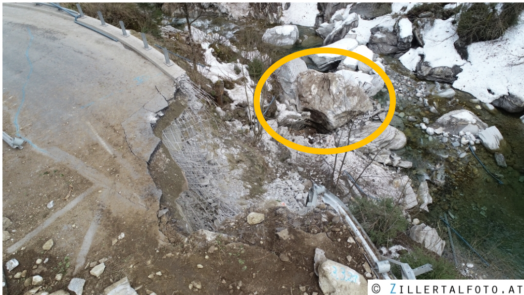
Abb. 6: Die schwer beschädigte Zillertalstraße (B 169) nach dem Felssturz vom 3. März 2021 auf Höhe des Straßenkilometers 34,96 im Gemeindegebiet von Finkenberg (Bundesland Tirol) mit Blick auf den Zemmbach und den dort liegenden Sturzblock (gelbe Umrahmung) (© Foto: Markus Sporer/„Zillertalfoto“; Quelle: „Zillertalfoto“) [1].
