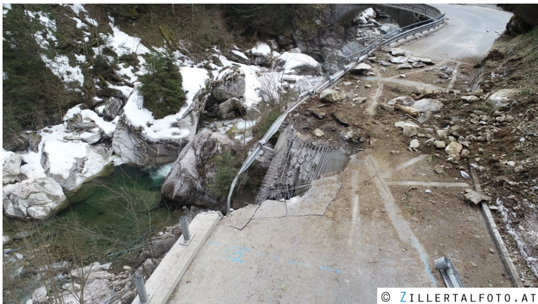
Abb. 8: Die schwer beschädigte Zillertalstraße (B 169) nach dem Felssturz vom 3. März 2021 auf Höhe des Straßenkilometers 34,96 im Gemeindegebiet von Finkenberg (Bundesland Tirol) mit Blick auf den Zemmbach und Richtung Karlstegbrücke (© Foto: Markus Sporer/„Zillertalfoto“; Quelle: „Zillertalfoto“) [1].
