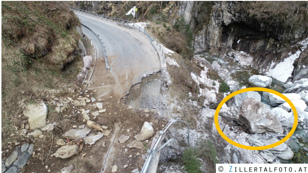
Abb. 7: Die schwer beschädigte Zillertalstraße (B 169) nach dem Felssturz vom 3. März 2021 auf Höhe des Straßenkilometers 34,96 im Gemeindegebiet von Finkenberg (Bundesland Tirol) mit Blick auf den Zemmbach und den dort liegenden Sturzblock (gelbe Umrahmung) (© Foto: Markus Sporer/„Zillertalfoto“; Quelle: „Zillertalfoto“) [1].
