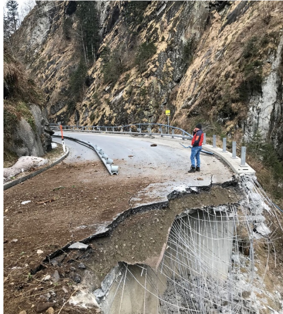
Abb. 5: Erste Pressemitteilung des Landes Tirol zum Felssturz vom 3. März 2021 auf die Zillertalstraße (B 169) auf Höhe des Straßenkilometers 34,96 zwischen Bösdornau und Ginzling im Gemeindegebiet von Finkenberg (Bundesland Tirol) (© Foto: Johann Schroll/Land Tirol; Quelle: Webseite des Landes Tirol) [3].
