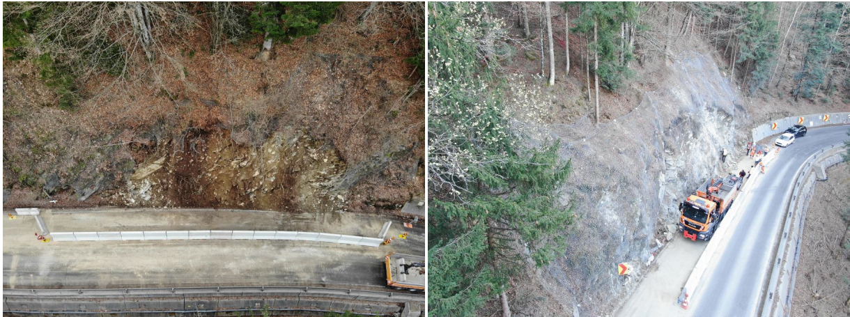
Abb. 20: Felsböschung mit Steinschlagaktivität an der Weizer Straße (B 72) auf Höhe des Straßenkilometers 56,0 zwischen Birkfeld und der Abzweigung nach Strallegg im Gemeindegebiet von Strallegg nach der Beräumung der Felswand (links) und während der Anbringung der Felsvernetzung (rechts) (© Fotos: Holler/Fachabteilung Straßenerhaltungsdienst (STED) des Landes Steiermark; Quellen: Webseiten des Landes Steiermark) [20], [21].
