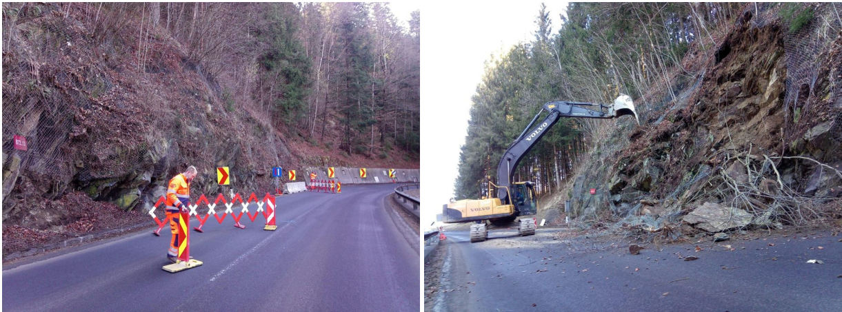
Abb. 18: Felsböschung mit Steinschlagaktivität an der Weizer Straße (B 72) auf Höhe des Straßenkilometers 56,0 zwischen Birkfeld und der Abzweigung nach Strallegg im Gemeindegebiet von Strallegg am 3. März 2021 (© Fotos: Fachabteilung Straßenerhaltungsdienst (STED) des Landes Steiermark; Quelle: Facebook-Seite des Straßenerhaltungsdienstes (STED) des Landes Steiermark) [18].
