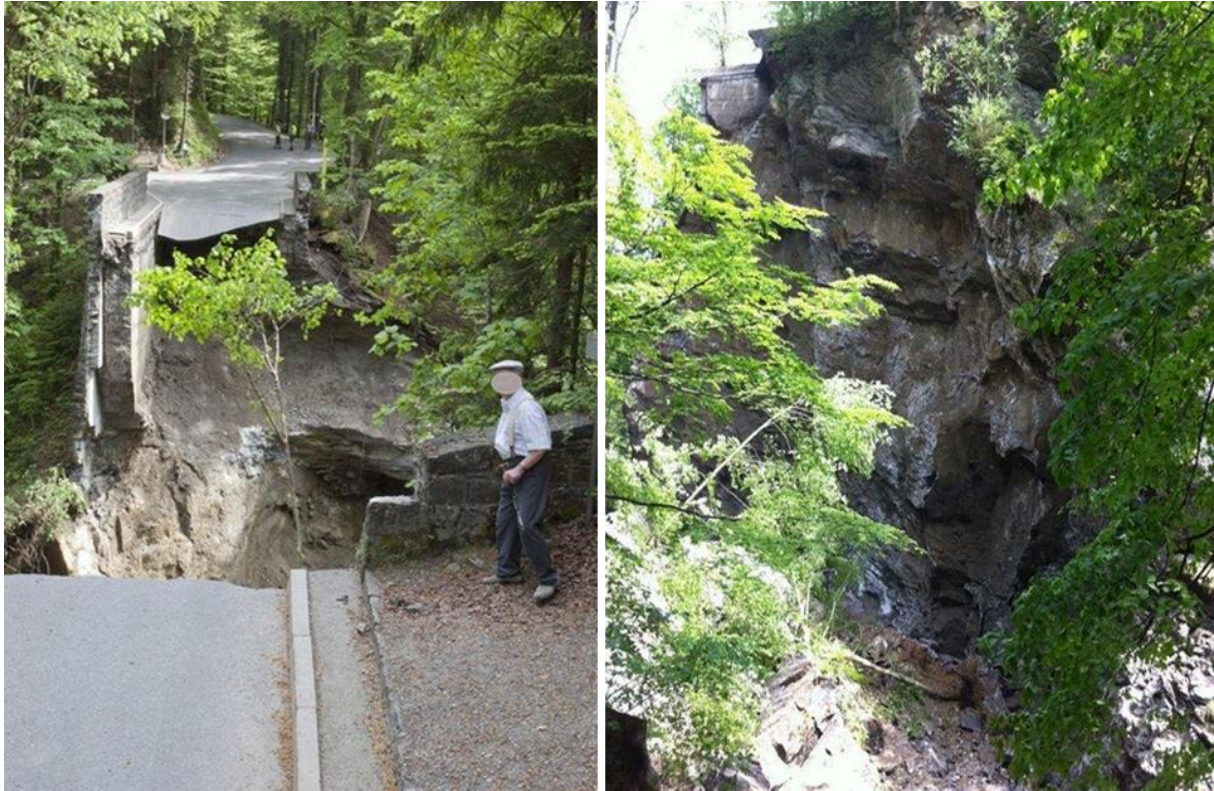
Abb. 6: Die eingestürzte Rappenlochbrücke nach dem Felssturz am 10. Mai 2011 (links) und die betroffene Felsflanke in der Rappenlochschlucht (rechts) zwischen Dornbirn und Ebnit auf dem Gebiet der Stadtgemeinde Dornbirn (Bundesland Vorarlberg) (© Fotos: K. Hartinger; Quelle: „Vorarlberg“-online [6] und Schmidt/„Vorarlberg“-online; Quelle: „Vorarlberg“-online [4]).
