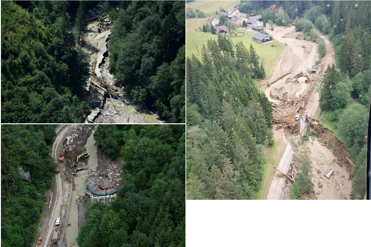
Abb. 54: Die am 29. Juni 2022 durch den Arriachbach völlig zerstörte Teuchen Straße (L 46) im Gemeindegebiet von Arriach (linkes Bild oben), die durch den Afritzer Bach schwer beschädigte Millstätter Straße (B 98) bei Straßenkilometer 3,6 zwischen der Inneren Einöde und der Abzweigung nach Arriach im Gemeindegebiet von Treffen am Ossiacher See mitsamt dem zerstörten Kleinwasserkraftwerk (linkes Bild unten) und der Blick vom Ausgang der Arriacher Klamm südlich der Ortschaft Auf der Tratten und unmittelbar westlich der Abzweigung der Buchholzer Straße (L 45a) gegen Osten über das Gemeindegebiet von Arriach mit der Teuchen Straße (L 46) und dem Arriachbach (rechtes Bild) (© Fotos: Michael Schoberleitner/Österreichisches Bundesheer (BMLV); Quelle: Webseite des Bundesministeriums für Landesverteidigung) [1], [88].
