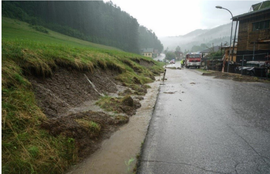
Abb. 40: Böschungsrutschungen an der Weingarterstraße zwischen den Ortschaften Thernberg und Neustift im Gemeindegebiet von Scheiblingkirchen-Thernberg (Bundesland Niederösterreich) vom Abend des 7. Juni 2022 (© Foto: Patrick Lechner/„einsatzdoku.at“; Quelle: Webseite von „einsatzdoku.at“) [48].
