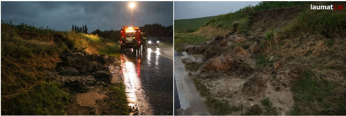
Abb. 25: Böschungsrutschung vom Abend des 5. Juni 2022 an der Innviertler Straße (B 137) ca. bei km 5,7 südöstlich von Haiding in der Gemeinde Krenglbach (Bundesland Oberösterreich) (© Fotos: Matthias Lauber/„laumat.at media“; Quellen: Webseite der Freiwilligen Feuerwehr Haiding [40] und Webseite von „laumat.at media“ [103]).
