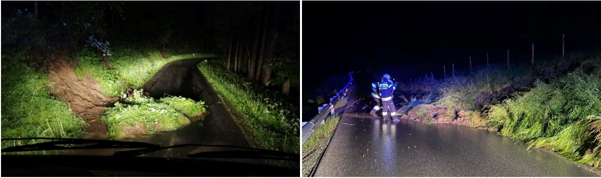
Abb. 33: Zwei Rutschungen an Straßenböschungen im Raum Heilbrunn im Gemeindegebiet von Anger (Bundesland Steiermark) in der Nacht vom 5. auf den 6. Juni 2022 (© Fotos: Freiwillige Feuerwehr Heilbrunn; Quelle: Facebook-Seite der Freiwilligen Feuerwehr Heilbrunn) [46].
