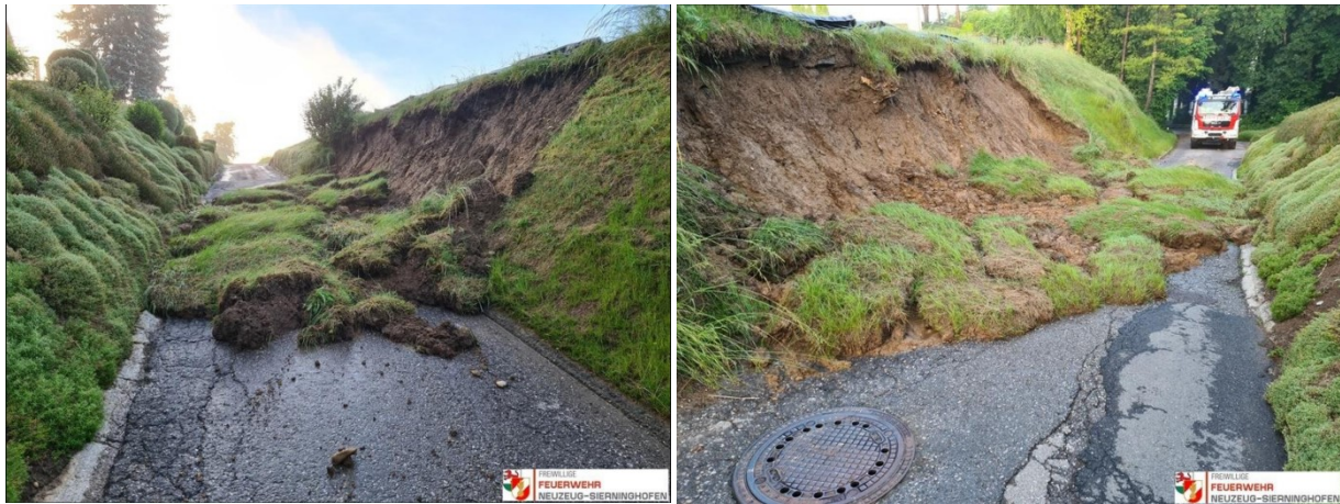
Abb. 23: Böschungsrutschung in der Nacht vom 3. auf den 4. Juni 2022 an der Pachsallernstraße in der Gemeinde Sierning (Bundesland Oberösterreich) (© Foto: Freiwillige Feuerwehr Neuzeug-Sierninghofen; Quelle: Webseite der Freiwilligen Feuerwehr Neuzeug-Sierninghofen) [38].
