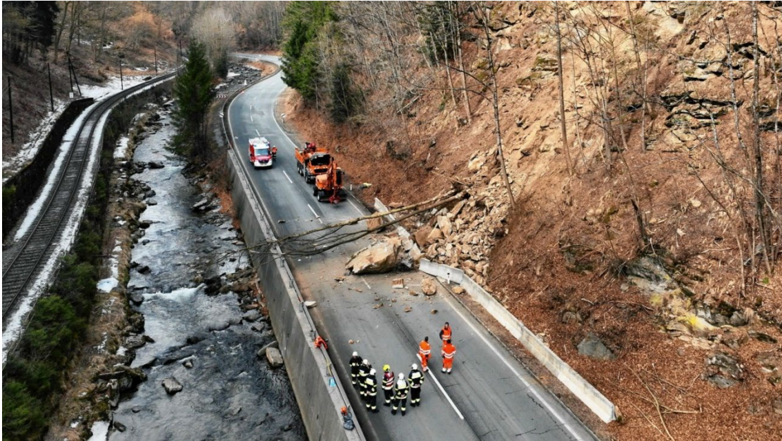
Abb. 10: Sturzblöcke vom 17. März 2022 auf der Packer Straße (B 70) bei km 81,650 im Twimberger Graben auf dem Gebiet der Stadtgemeinde Wolfsberg (Bundesland Kärnten) nach dem Arbeitsunfall mit zwei Verletzten während der Hangsicherungsmaßnahmen nach zumindest einem Steinschlagereignis wahrscheinlich Anfang März 2022 (© Foto: Gerd Eggenberger; Quelle: „Kronen Zeitung“-online) [16].
