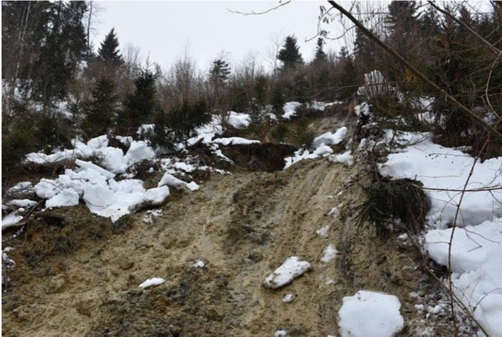
Abb. 19: Abrissbereich der Hangmure vom 20. Februar 2022 im Ortsteil Schorn in der Gemeinde Abtenau (Bundesland Salzburg) (© Foto: Freiwillige Feuerwehr Abtenau; Quelle: Webseite der Freiwilligen Feuerwehr Abtenau) [28].
