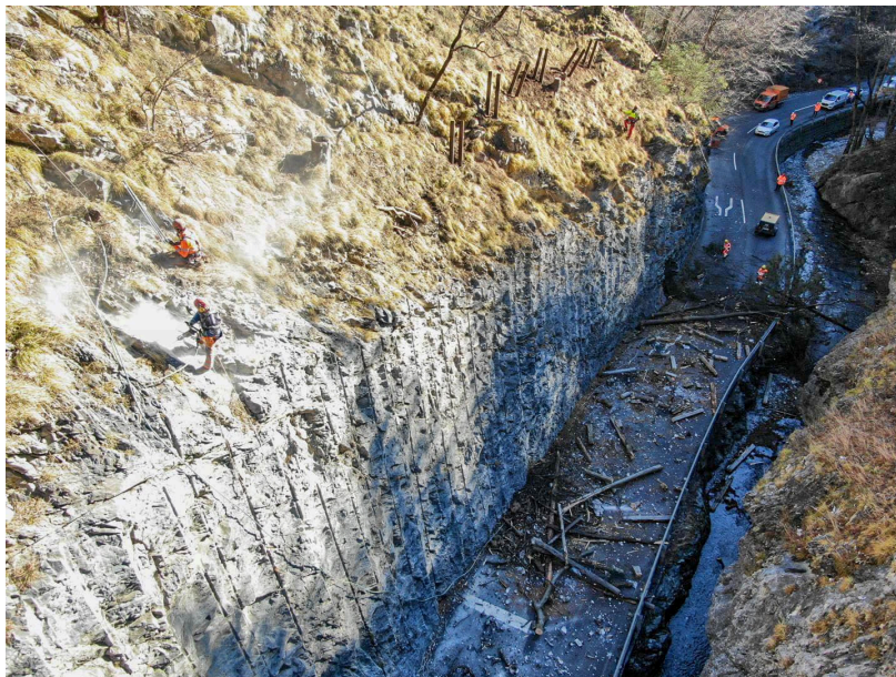
Abb. 6: Die Rechberg Straße (B 64) in der Weizklamm auf Höhe des Straßenkilometers 20,9 im Gemeindegebiet von Naas (Bundesland Steiermark) während der Hangsicherungsmaßnahmen nach den Steinschlägen vom 3. Februar 2022 (© Foto: Fachabteilung Straßenerhaltungsdienst (STED) des Landes Steiermark; Quelle: Facebook-Seite des Straßenerhaltungsdienstes (STED) des Landes Steiermark) [9].
