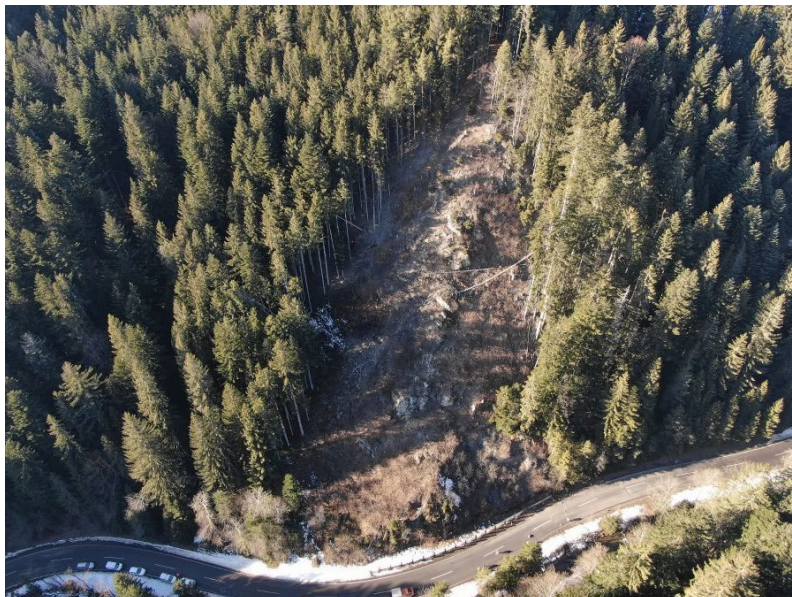
Abb. 11: Hangflanke an der Vorauerstraße (L 405) im Miesenbachgraben nahe Gschaid bei Birkfeld im Gemeindegebiet von Birkfeld (Bundesland Steiermark), an der sich am 10. Februar 2022 mehrere Steinschläge bzw. Felsstürze zugetragen haben (© Foto: Stefan Holler/Straßenerhaltungsdienst (STED) des Landes Steiermark; Quelle: Webseite des Landes Steiermark) [12].
