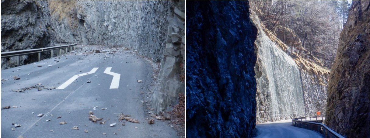
Abb. 7: Die Rechberg Straße (B 64) in der Weizklamm auf Höhe des Straßenkilometers 20,9 im Gemeindegebiet von Naas (Bundesland Steiermark) während der Hangsicherungsmaßnahmen nach den Steinschlägen vom 3. Februar 2022 (© Fotos: Fachabteilung Straßenerhaltungsdienst (STED) des Landes Steiermark; Quelle: Facebook-Seite des Straßenerhaltungsdienstes (STED) des Landes Steiermark) [9].
