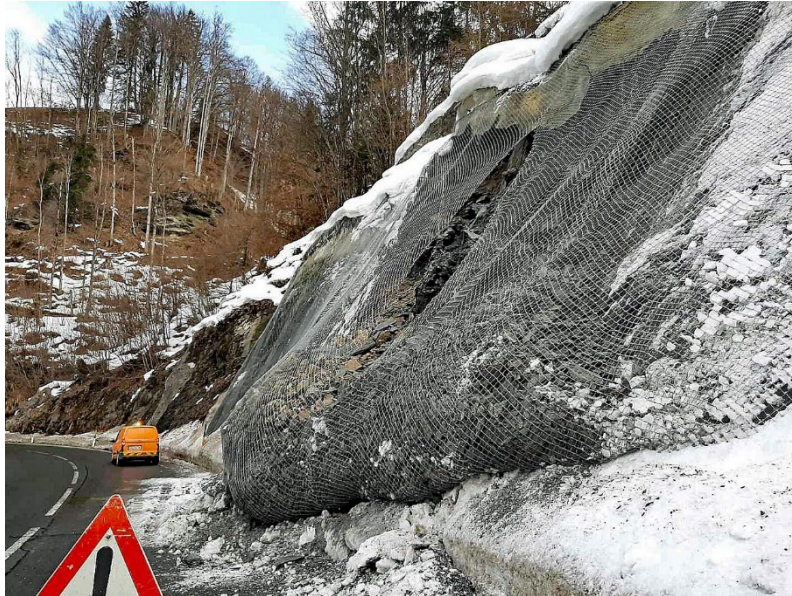
Abb. 22: Beschädigte Hangvernetzung mit abgeglittenem Gesteinsmaterial an der Katschbergstraße (B 99) im Raum Sonnhalm zwischen Pöham und Hütttau im Gemeindegebiet von Hütttau (Bundesland Salzburg) am 21. Februar 2022 (© Foto: Hannes Mußbacher/Straßenmeisterei Pongau (Land Salzburg); Quelle: ORF-online) [1].
