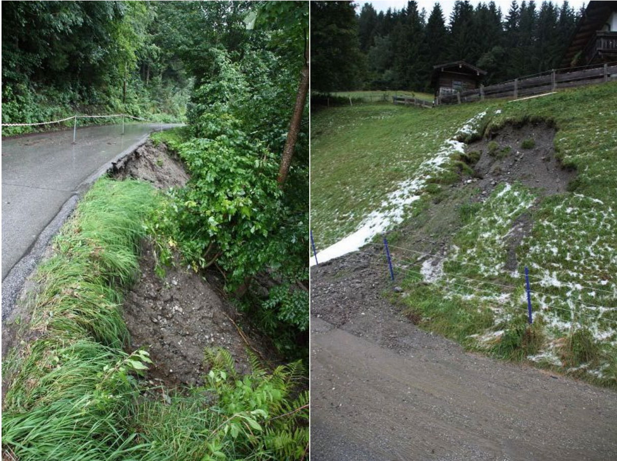
Abb. 23: Talseitige (linkes Bild) und bergseitige Böschungsruhrsung (rechtes Bild) an der Innerbergstraße in der Gemeinde Kolsassberg (Bundesland Tirol) vom 16. August 2021 (© Fotos: Andreas Reiter/Freiwillige Feuerwehr Kolsassberg; Quelle: Webseite der Freiwilligen Feuerwehr Kolsassberg) [25].
