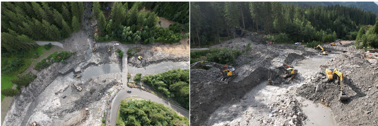
Abb. 12: Die Einmündung des Bräuergrabens (im linken Foto mittig in der oberen Bildhälfte, im rechten Foto auf der linken Seite) in die Krimmler Ache im Grenzgebiet der Gemeinden Wald im Pinzgau und Krimml (Bundesland Salzburg) am 18. August 2021 nach dem dritten Murenabgang im Bräuergraben am 16. August 2021 (© Fotos: Militärkommando Salzburg/Bundesministerium für Landesverteidigung; Quelle: Webseite des Bundesministeriums für Landesverteidigung) [1].
