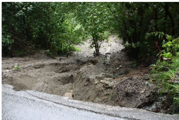
Abb. 24: Talseitige Böschungsruhrsung an der Innerbergstraße in der Gemeinde Kolsassberg (Bundesland Tirol) vom 16. August 2021 (© Foto: Andreas Reiter/Freiwillige Feuerwehr Kolsassberg; Quelle: Webseite der Freiwilligen Feuerwehr Kolsassberg) [25].
