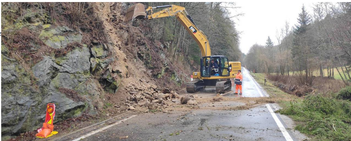
Abb. 9: Berichterstattung über die Sturzereignisse an der Nibelungenstraße (B 130) im Raum Sieberstal in der Gemeinde Haibach ob der Donau (Bundesland Oberösterreich) am 22. und 23. Dezember 2019. (© Foto: Wolfgang Schnaitl/ORF; Quelle: ORF-online) [10].
