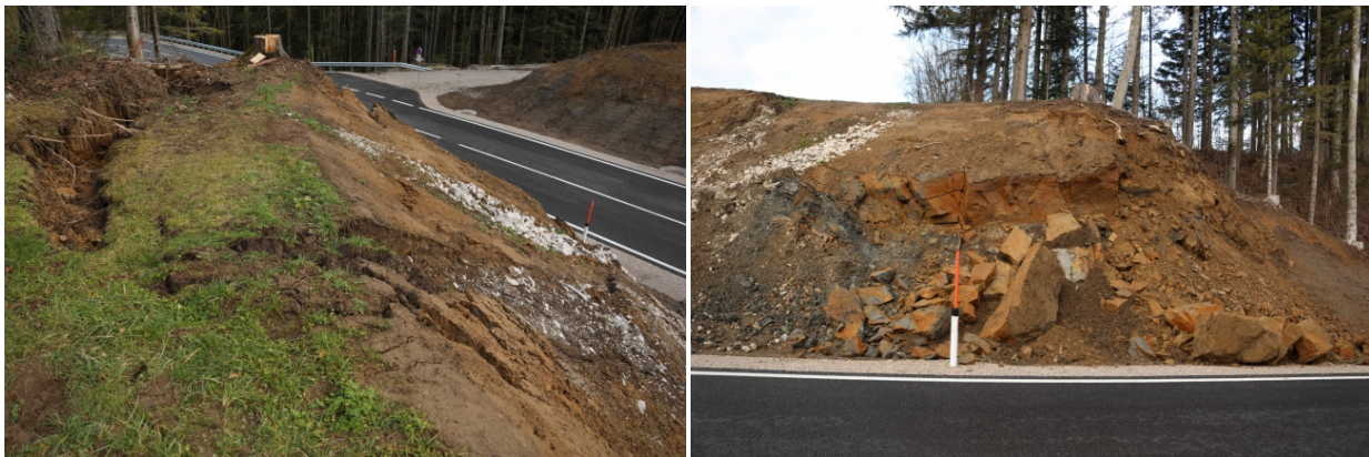
Abb. 11: Weitere Berichterstattung über die Böschungsrutschung an der Ausbaustrecke der Scharnsteiner Straße (B 120) im Gemeindegebiet von St. Konrad (Bundesland Oberösterreich) in der Nacht vom 23. auf den 24. Dezember 2019 (© Fotos: Matthias Lauber/„Laumat-Media“; Quelle: Webseite von „Laumat-Media“) [16].
