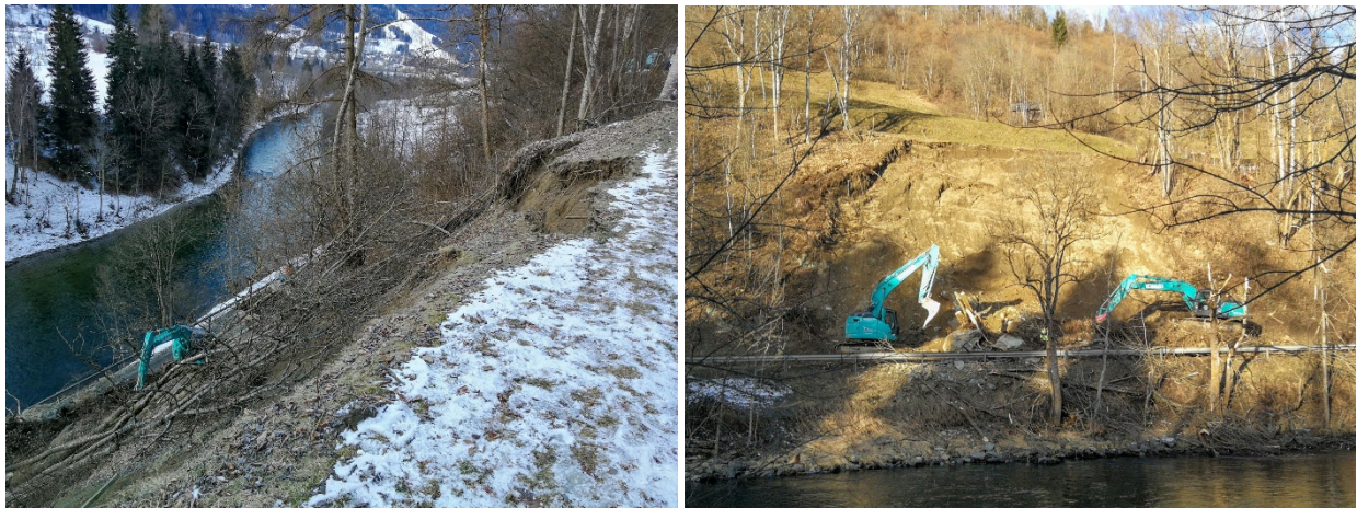
Abb. 20: Bilder des am 28. Dezember 2019 abgerutschten Hanges an der Murauer Straße (B 97) bei km 4,7 in der Gemeinde St. Georgen am Kreischberg (Bundesland Steiermark) während der Aufräumarbeiten (© STED Steiermark; Quelle: Facebook-Seite des Straßenerhaltungsdienstes des Landes Steiermark) [27].
