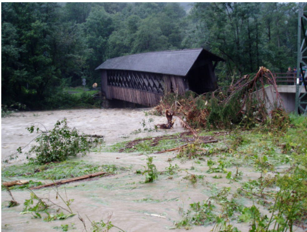
Abbildung 8: Beschädigte Holzbrücke Galgenul
