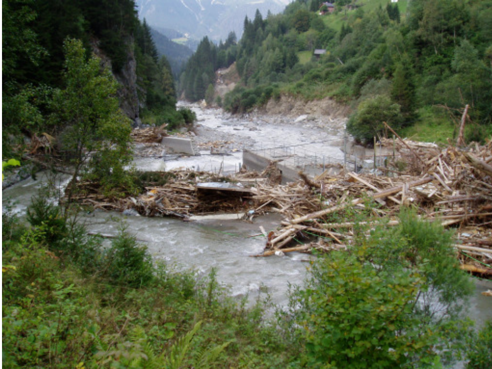
Abbildung 4: Hochwasserschäden Fassung Gfäll
