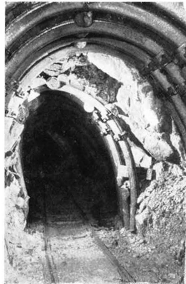
Abb. 12: Nachriß einer streichenden Strecke in der Lagerstätte zum Ausgleich der fortschreitenden Verdrückung und Verschiebung durch deren Verformung im „Talzus Schub“. (aus CLAR u. WEISS)
