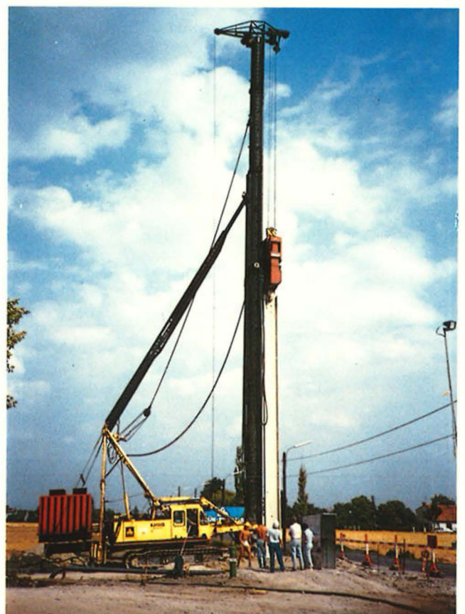
Abb. 8: Rammeinheit zur Herstellung von 25 m tiefen Schmalwänden Fig. 8: Driving unit for constructing thin diaphragm walls (vibrated beam slurry walls) of 25 m depth
