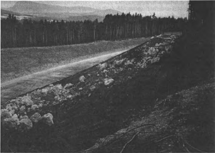
Abb. 4: „Reibungsteppich“ aus Karbonatblöcken für einen neuerlichen Böschungsaufbau, im gleichen Einschnitt wie bei Abb. 3.
