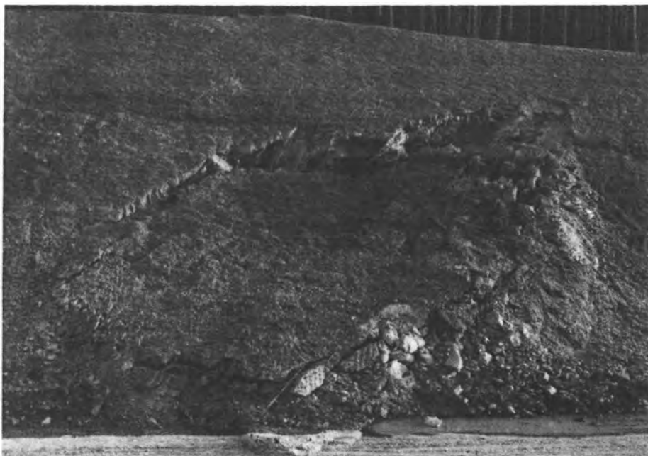
Abb. 2: En-bloc-Gleitung in Phylliten an der linken Böschung eines etwa 15 m tiefen Einschnittes.
