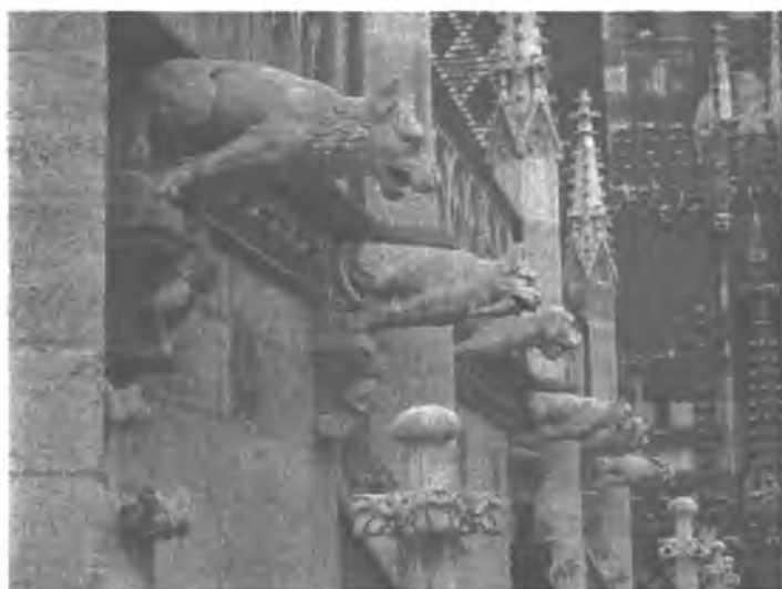
Abb.2: Wasserspeier am Nordchor von St. Stephan in Wien, Auer Kalksandstein um 1350, nach Restaurierung
