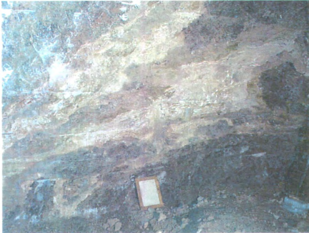
Abbildung 6: Tektonische Zertrümmerung des Hauptdolomites im Kienberg-Fluchtstollen
