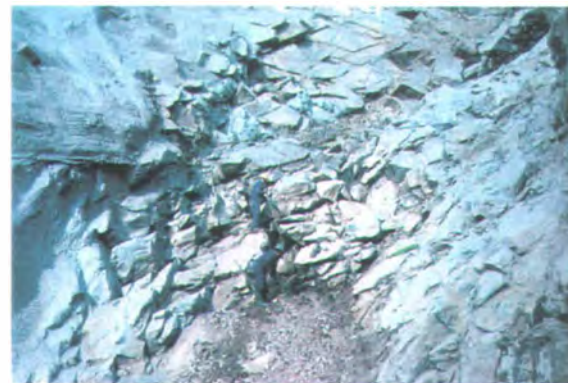
Abb. 38: Sperrre Paal, starke Gefügauflockerungen
