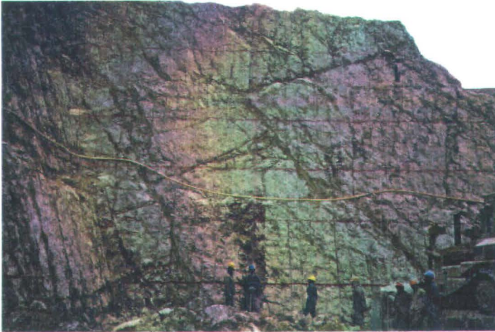
Abb. 3 Schichtflächen parallele Scherzonen in Kalk, hervorgerufen durch Biegegleitfallung , versetzen SW-fallende Störungsbahnen in Richtung Faltenscharnier (= links oben) Linkes Widerlager , Aussichtsplattform Strichpunktliert , Scherzone, strichliert Störung
