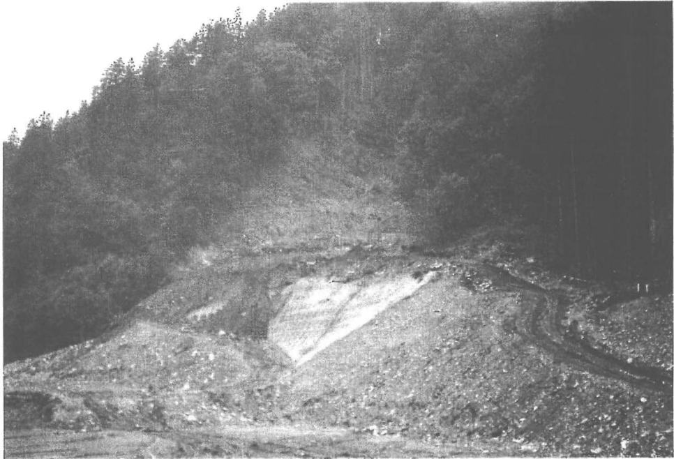
Abb. 6: Tunnel Wald, Voreinschnitt Ostportale: Abräumen der mächtigen, nachdrängenden Schuttansammlungen einer Felsrinne; darunter sichtbare temporäre Böschungssicherung ist bereits unstabil.
