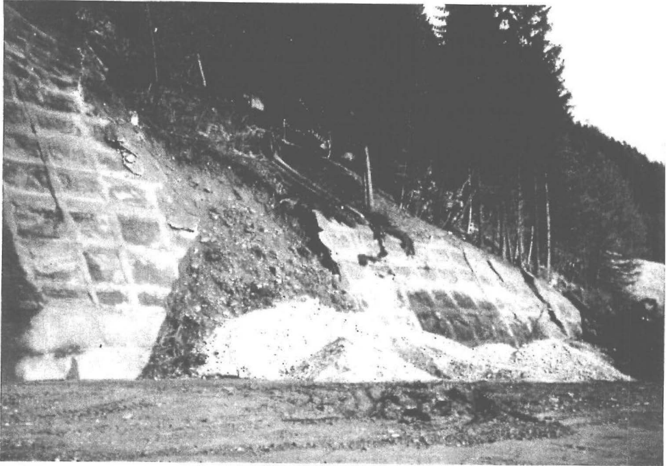
Abb. 7: Pretallerkogeltunnel, Bereich Ostportale; Geborstene und vorgeschobene Böschungssicherung nach dem Einsetzen von Massenbewegungen in der Lockermaterialfüllung steiler Felsrinnen.
