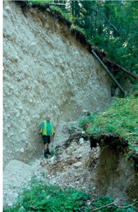
Abb. 6: Hauptanbruchfläche der Rutschung am Holzwerkgraben.
