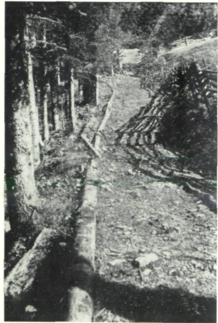
Abb. 6: Primitive Holzrohre, die nicht selten stark vermodert sind, sind die Trinkwasserzuleitungen über beträchtliche Entfernungen. Wasserverluste und Verunreinigung des Trinkwassers sind die Regel (Ramsau).
