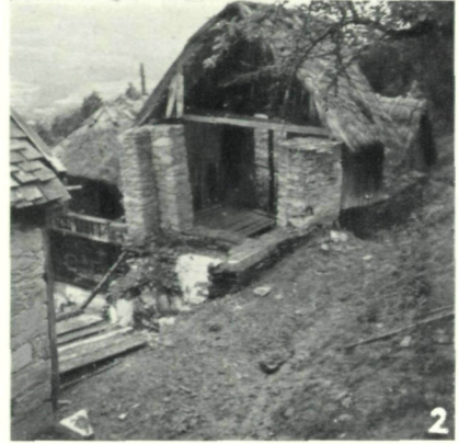
Abb. 2: Durch Rutschung zerstörtes Gehöft Heil in Zeil-Pöllau.
