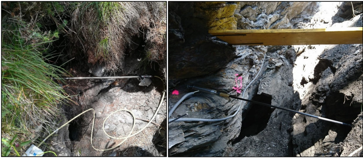
Abbildung 5: Fissurometer und Konvergenzextensometer
