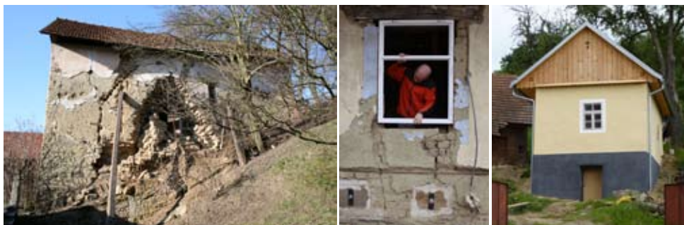
Abb. 2: Ausgedinge (von links): vor der Rekonstruktion, Verankerungsbereiche der Ankerschienen, Ausgedinge nach der Rekonstruktion
