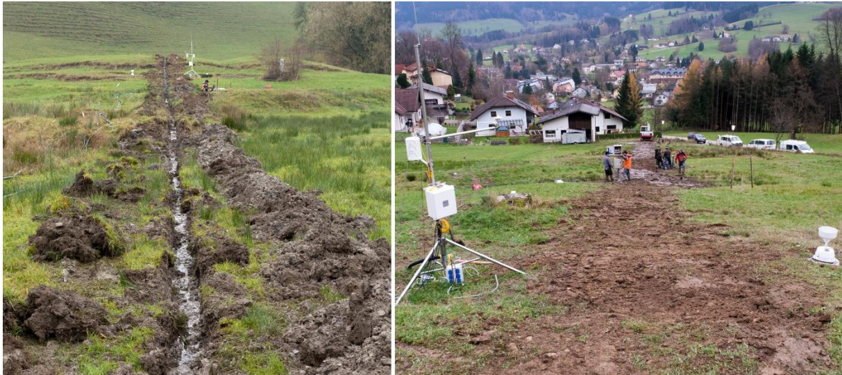
Abb. 19: Situationsfotos zur Installation des geoelektrischen Monitoring Systems
