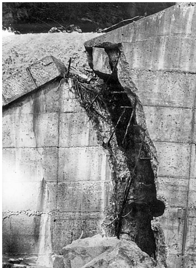
Abb. 36. Deutliche Spaltenbildung der Sperrenabstaffelung. Aufnahme Anfang der 1980er Jahre.
