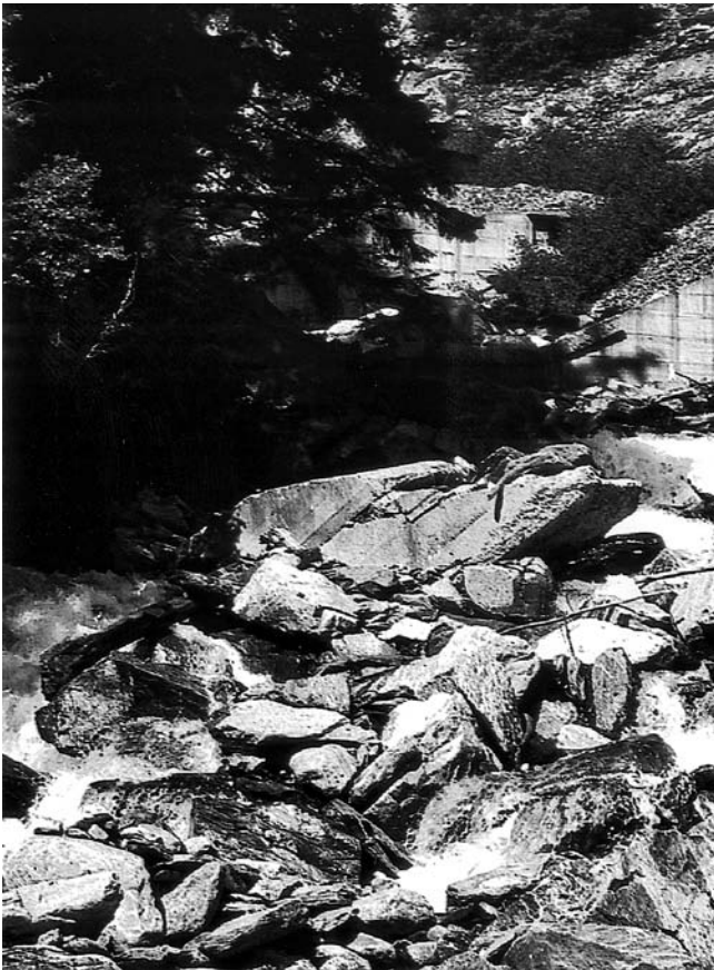
Abb. 37. Völlige Zerstörung der Sperrenabstufung. Aufnahme Anfang der 1980er Jahre.
