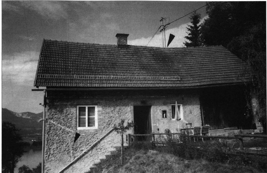
Abb. 10. Gebäudeschäden (Knick im Dach, Risse in den Wänden) am Haus Preliebl Nummer 1 verursacht durch Hangkriechen.
