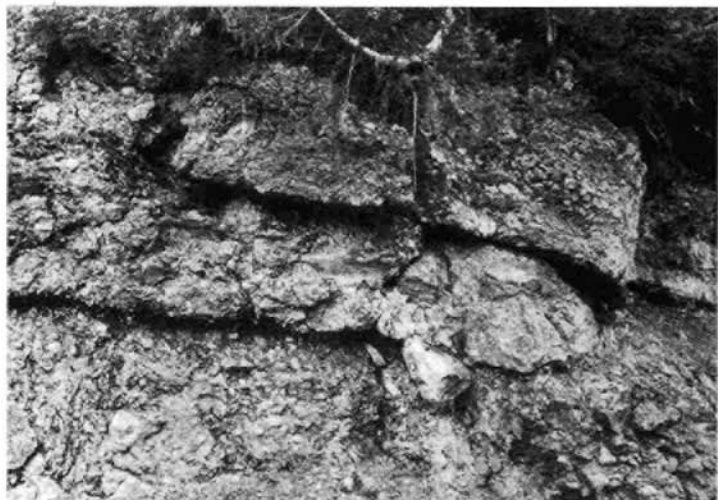
Abb. 9: Roterdebreccie-Generations, aufgeschlossen in 1000 m an der zur Tommerlalm neuerbauten Forstauschließungsstraße. Das Alter ist möglicherweise Gosau: erstaunlich sind hiebei die in situ erscheinenden Schichten von Roterdeauflagen, die sich hier unverfestigt erhalten haben. Die hier schwarz erscheinenden Lagen zeigen sich in Wirklichkeit in einem purpurfarbenem Rot.
