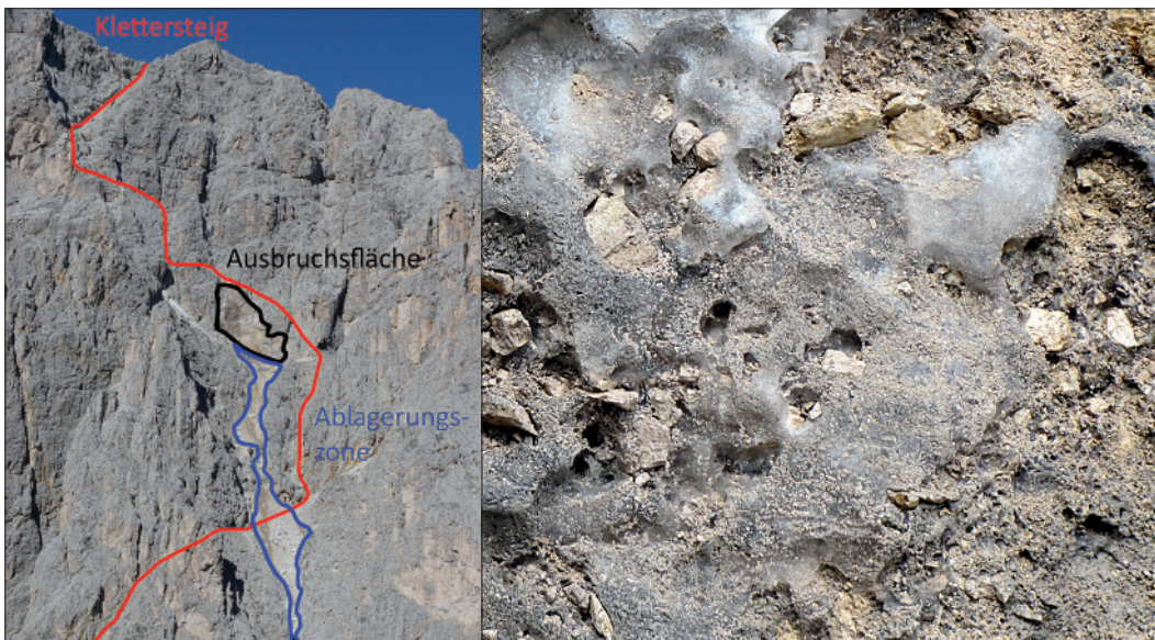
Abb. 8, 9: Die Ausbruchfläche, die Route des Oskar Schuster Klettersteiges am Plattkofel (links) und das Eis im Bereich der Ausbruchfläche, zwei Tage nach dem Ereignis (rechts).
