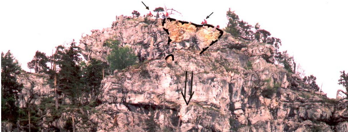
Abb. 10a: Felssturz Ansetz; die Pfeile zeigen Arbeiter bei der Sanierung der Abbruchstelle (Foto: Salzkammergut –Rundschau/Aigner 1998)
