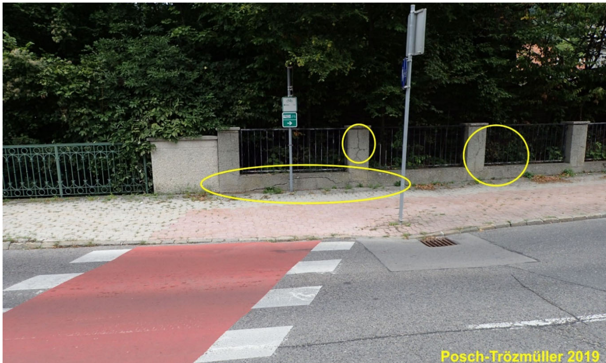
Abb. 3.6.: Schäden an einer Mauer (gelbe Markierungen) an der Hauptstraße gegenüber der Abzweigung Hohlgasse.
