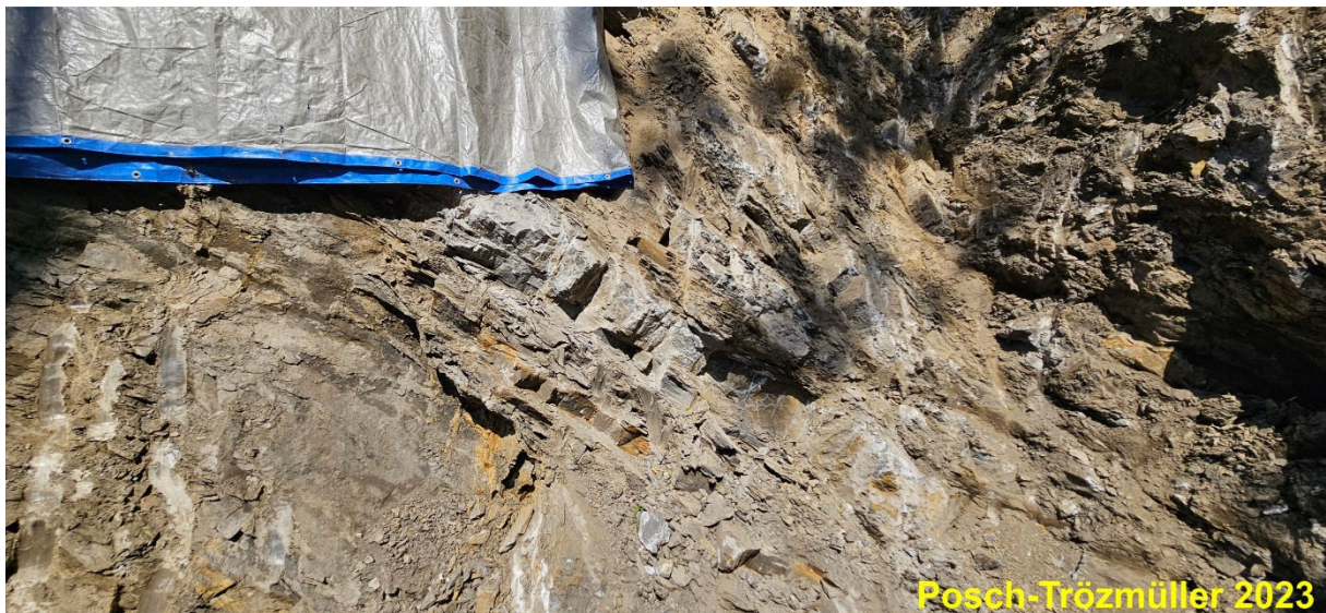
Abb. 4.23.: Wechselfolge aus Kalkbänken und grau-schwarzen Schiefen in der N-Wand (bzw. NE-Eck) der Baugrube Hauptstraße 80-82.
