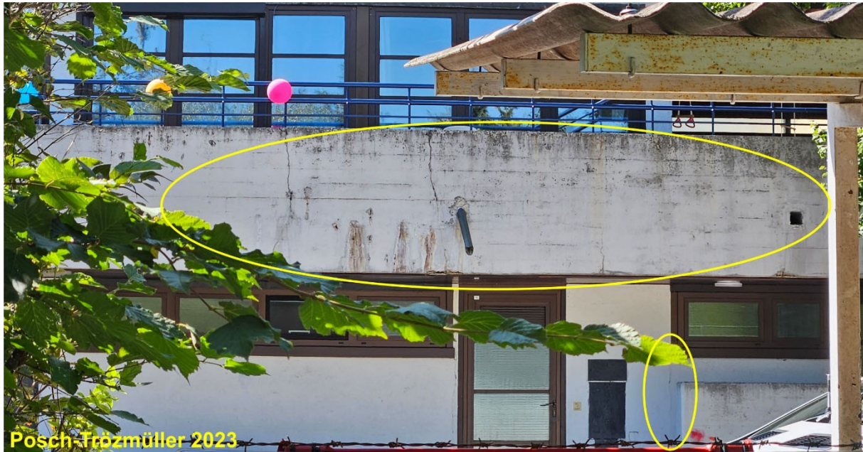
Abb. 3.5.: Risse im Gebäude des SOS Kinderdorfs in der Hauptstraße 146, hier von der Robert-Lieben-Promenade aus gesehen.
