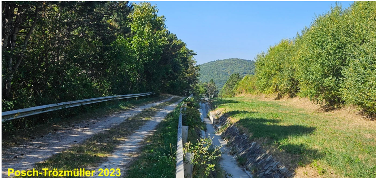
Abb. 4.8.: Betonierte Rinne entlang der Autobahn A 21 (diese befindet sich hinter der Buschreihe rechts im Bild), Blickrichtung W.
