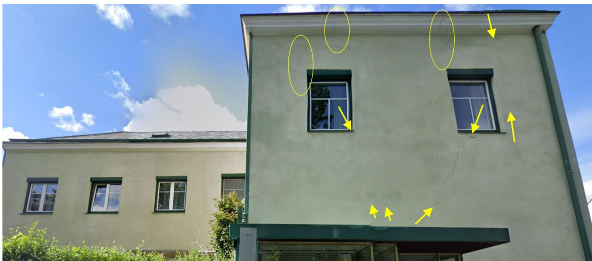
Abb. 3.7.: Risse im Haus an der Adresse Hauptstraße 102 (Quelle: Google Street View, Mai 2023).
