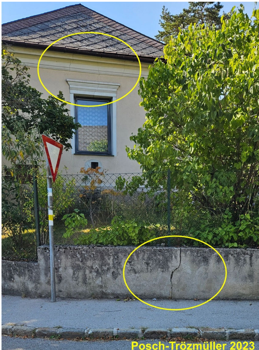
Abb. 3.3.: Risse an Haus und Gartenmauer des Grundstücks Weissenbach 30.
