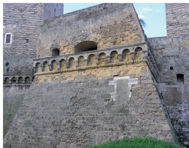
FIG. 1: L'edificio storico presenta ammaloramenti, ma ciò che disturba maggiormente è l'intervento di restauro con materiale lapideo differente da quello originale per litologia, colore, forma, pezzatura e finitura: un palese esempio di ignoranza
