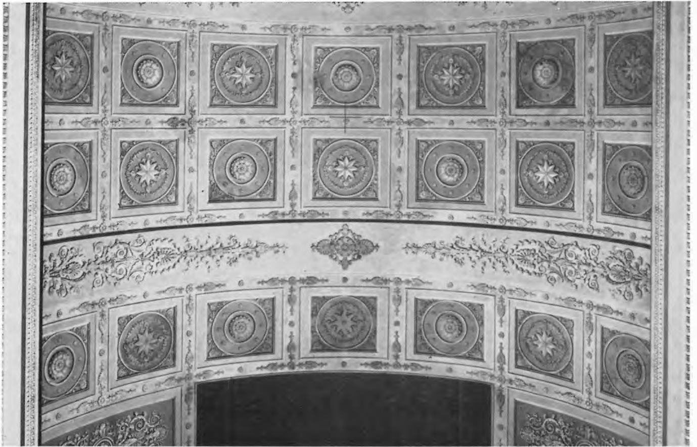
Bild 1: Ausschnitt aus einer um den Faktor 2,1 vergrößerten Zenitaufnahme des Bibliotheksaales des Wiener Schotten-Stiftes (Aufnahmekamera: Wild P 31, Kammerkonstante: 99,13 mm, Aufnahmeentfernung bis zum Scheitel des Tonnengewölbes: 11,80 m).
