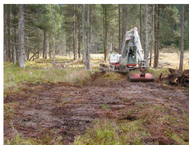
Abb. 32: Bei der Errichtung der Staus durch den Moorbagger entstehen teilweise offene Torfböden. Bereich von Graben 1 (Stau 1.1) bzw. von Transekt TS1. 4.11.2013. (Fotos Abb. 31 & 32: Georg Amann)
