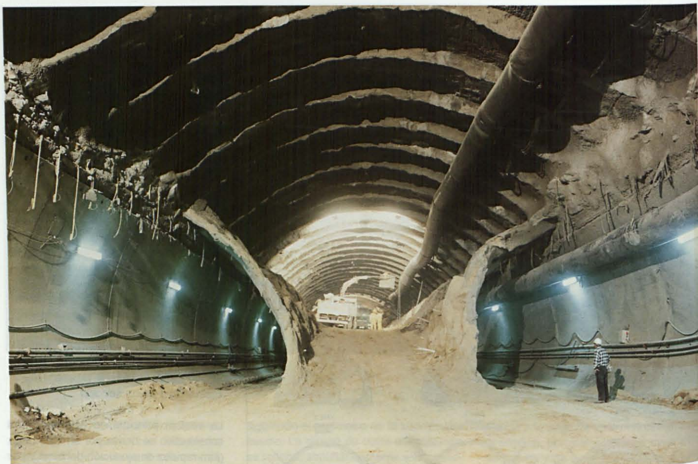
Figura 5: detalle de prebóvedas y galerías de avance en los túneles de el pardo.
