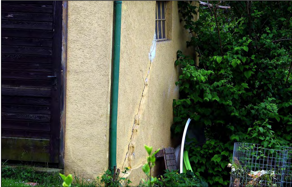
Abb. 4.37: Fortschreitende Rissbildung an einem Wirtschaftsgebäude in Hornstein, Ortsteil Graben (Bewegung N24).
