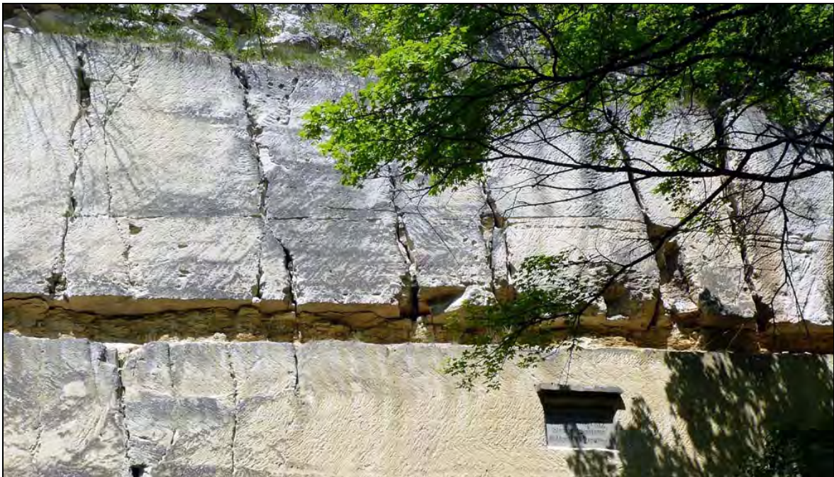
Abb. 4.11: Aufgelassener Steinbruch E von Loretto in vor allem aus Corallinaceae aufgebauten Leithakalk.
