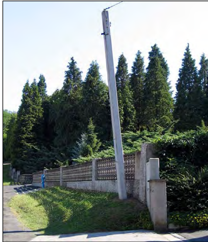
Abb. 6.19: Hebungen und Schrägstellung eines Mastes im zentralen Bereich der Bewegung S95 in Rotenturm.
