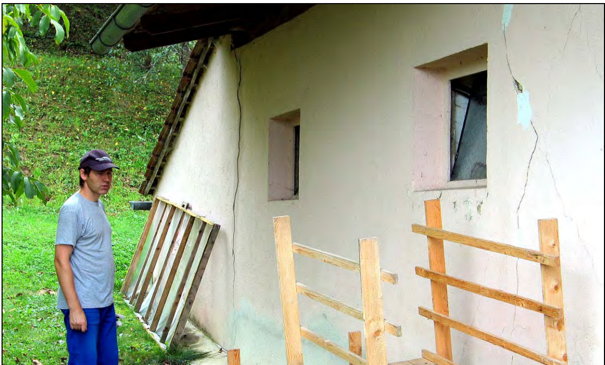
Abb. 6.43: Starke Mauerrisse am Wirtschaftsgebäude, hervorgerufen durch den Kriechbewegung S8 im Hintergrund.
