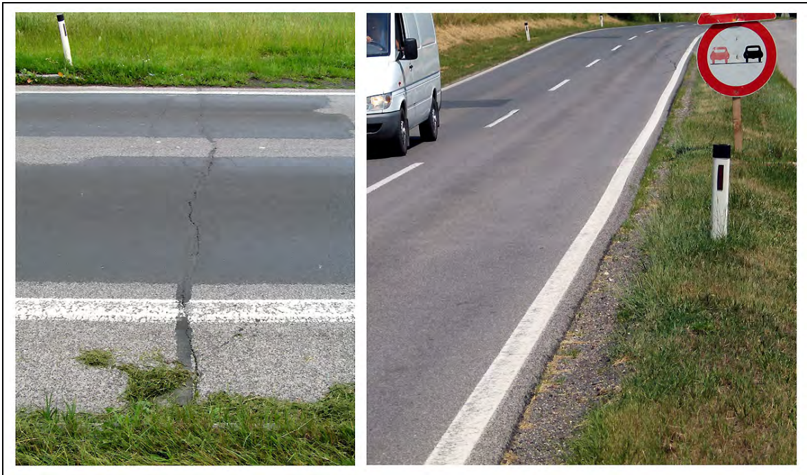
Abb. 5.12: Straßenschäden die durch die Bewegungen M3 (links, Querrisse die tief in den Unterbau der Straße reichen) und M7 (rechts, Setzungen) verursacht wurden. Beide Bewegungen SW von Mannersdorf an der Rabnitz.
