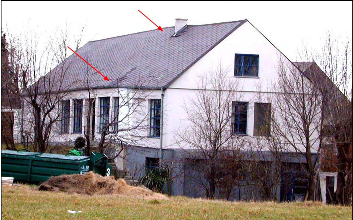
Abb. 4.33: Haus in Baumgarten in der Dr. Karl Rennerstraße im März 2002: Etwa ein Drittel des Hauses wurde durch Bewegungen und starke Setzungen erfasst und verstellt. Im Sommer 2008 wurde das Haus zum Teil abgetragen vorgefunden.
