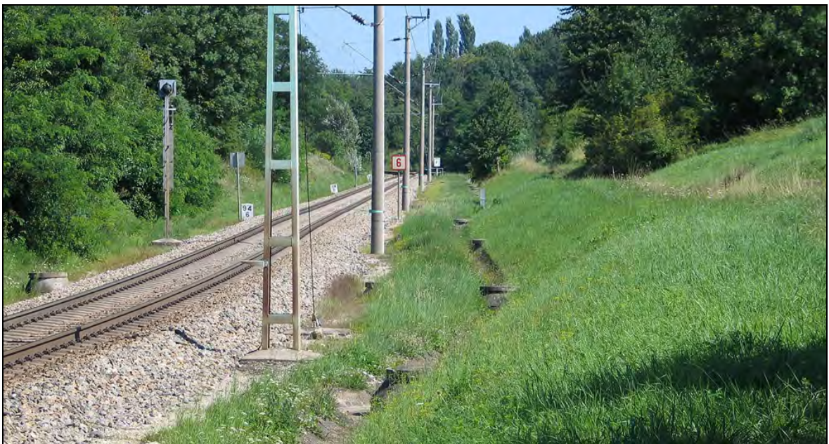
Abb. 4.30: Situation an der Raaberbahn im Jahr 2008, Position wie Abbildung 4.28, Blickrichtung E. Trotz fortlaufender, umfangreicher Sanierungen sind die Bewegungen des Gleiskörpers, verursacht durch die Kriechbewegung N4, nicht vollständig beherrschbar. Zu erkennen sind sehr junge Hebungen und Verstellungen der Gleise hinter dem Mast im Bildvordergrund sowie die mehrfache Verstellung des ursprünglich gerade ausgeführten Drainagegrabens in der Bildmitte und im Bildvordergrund.
