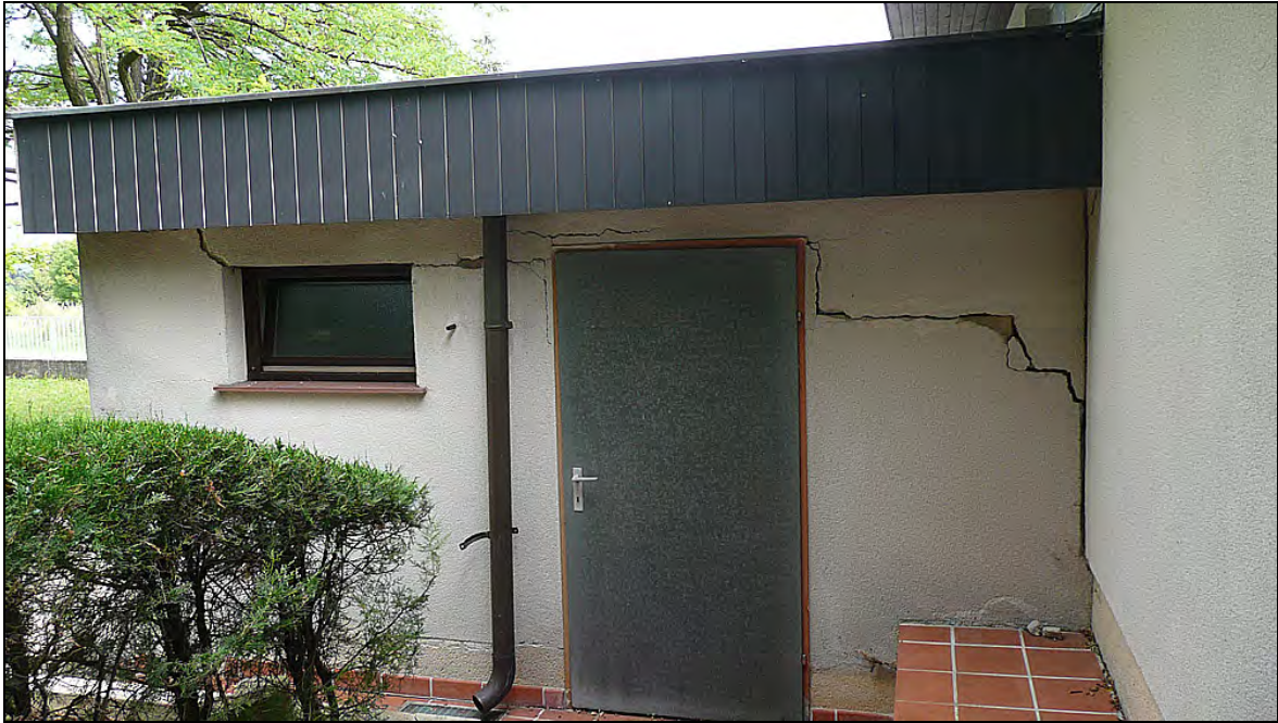
Abb. 4.32: Schäden am Haus Birkenweg Nr. 7 (Gemeinde Draßburg), die auf das Wirken der Bewegung N4 zurückzuführen sind.
