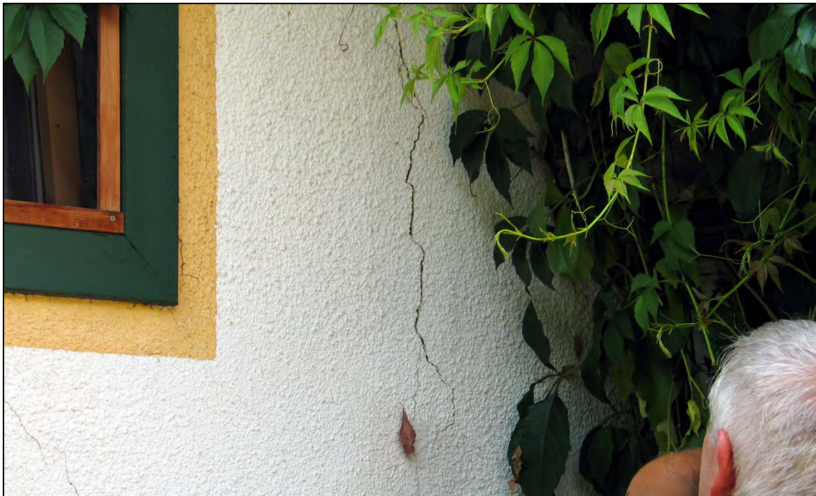
Abb. 6.39: Gebäudeschäden (Mauerrisse) am Wohnhaus innerhalb der Bewegung S28.
