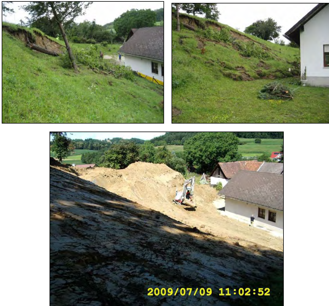
Abb. 6.33: Aufnahmen vor und während der Sanierung der schnellen Bewegung 21 in Neusiedl bei Güssing (Fotos mit freundlichen Genehmigung des Technischen Büros Dr. Josef Hofer).
