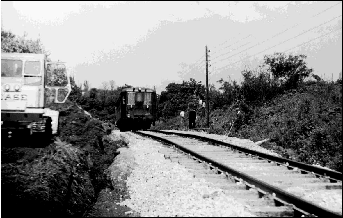
Abb. 4.29: Situation an der Raaberbahn im Jahr 1964, Position wie Abbildung 4.28, Blickrichtung W. Das Wirken der Kriechbewegung N4 und den entsprechenden Sekundärbewegungen hat in einen Zeitraum von 2-3 Monaten zu einer Hebung des Gleiskörpers um etwa 12cm pro Tag geführt. Nur durch ständiges Abgraben des Materials konnte ein eingeschränkter Zugsverkehr aufrecht erhalten werden. Foto mit freundlicher Genehmigung der Raaberbahn.
