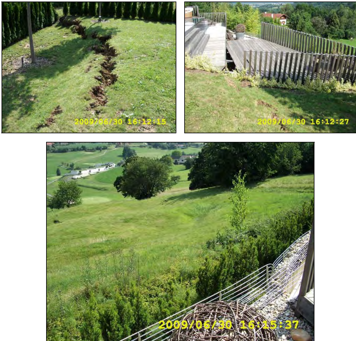
Abb. 6.34: Schäden durch eine Rutschung im Übergang zur Fließbewegung (Bewegung 6) bei Stegersbach (Fotos mit freundlichen Genehmigung des Technischen Büros Dr. Josef Hofer).
