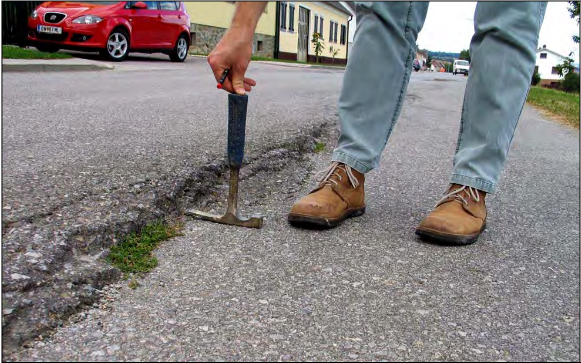
Abb. 6.21: Schäden an der talnahen Straße in Großpetersdorf, verursacht durch Hebungen der Bewegung S127.
