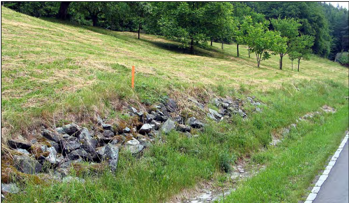
Abb. 5.10: Nach Osten gerichteter Blick auf die Rutschung M4, W von Karl. Im Vordergrund ist eine bereits wieder beschädigte Sanierung in Form eines Steinwurfs aus dem Jahre 2003 erkennbar, im Hintergrund die stark wellige Morphologie der Kriech- bzw. Rutschmasse.
