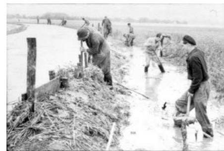
Abbildung 2: Das Neue Deutschland kommentierte: „Um die kornschweren Felder vor Überschwemmungen zu schützen, errichteten Dresdner Arbeiter in Tag und Nachtarbeit Schutzdämme“ (Neues Deutschland 14.07.1954)
