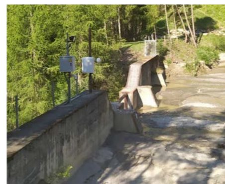
Abbildung 3: HF-Radar auf Retentionsbauwerk.
