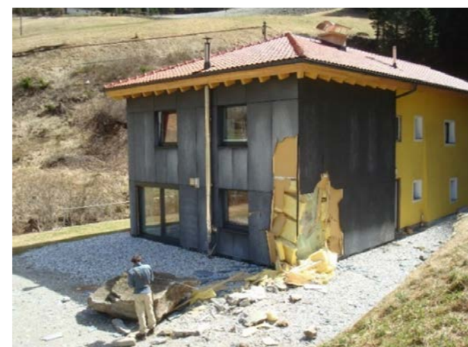
Abb. 1: Steinschlag: Schadblick 2011 und Sachschaden am Gebäude
