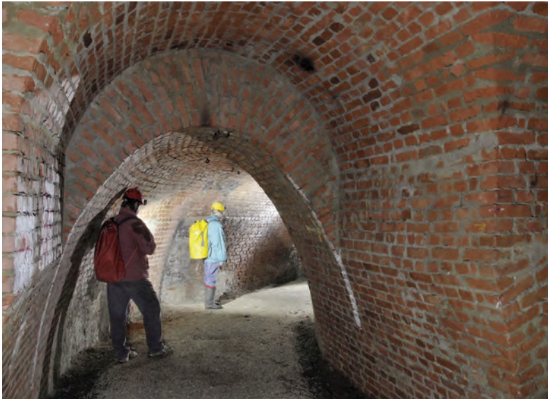
Abb. 36: Die auch ästhetisch anspruchsvolle Gewölbeausmauerung bei MP 3E zeugt von großer handwerklicher Kunst der Zwangsarbeiter. (Foto: H. Thaler).
