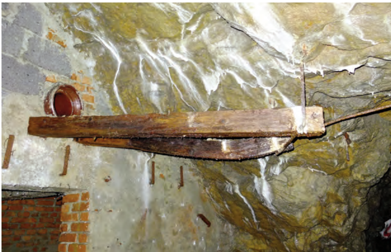
Abb. 13: Ein im Hauptgang gut sichtbarer – aber in Auflösung befindlicher – Holzbalken mit dem im Hintergrund liegenden Anschlussstück eines Keramikrohres zur Belüftung. (Foto: E. Fritsch).
