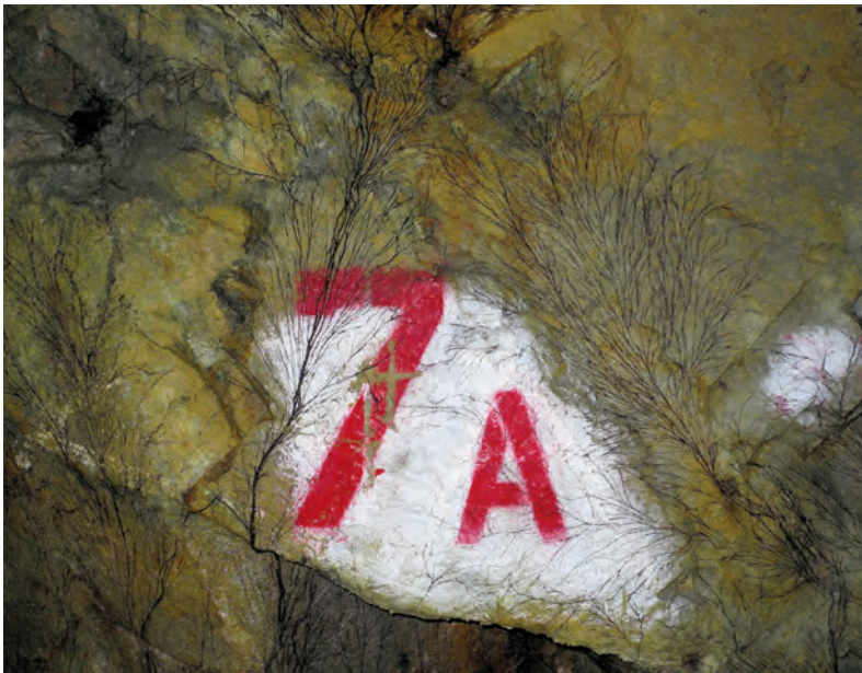
Abb. 27: Die Myzelien-Gesamtfläche um den MP 7A umfasst ca. 3x2 m im Wand- und Deckenbereich, Bildausschnitt ca. 2,0x1,5 m. (Foto: H. Thaler).
