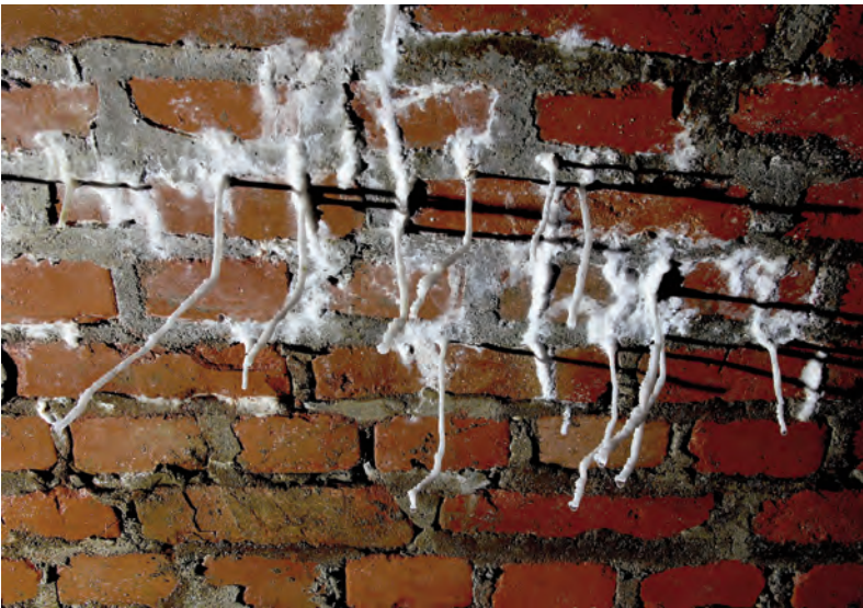
Abb. 32: Im nordöstlichen Stollenbereich bei MP 4B können mehrere bis zu 15 cm lange Excentriques am gemauerten Deckengewölbe beobachtet werden. (Foto: H. Thaler).
