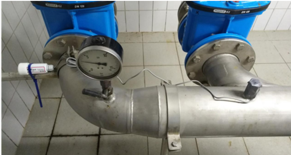
Abbildung 3: Einbau der Temperatursensoren mittels Tauchhülse
