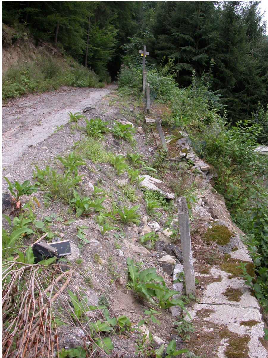
Abbildung 09 Blick nach S, Detailliertes Schadensbild am Güterweg hinter dem Schutzobjekt
