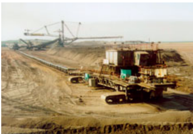
Abb. 5-2-49: Bandantriebsstation im Tagebau Espenhain
