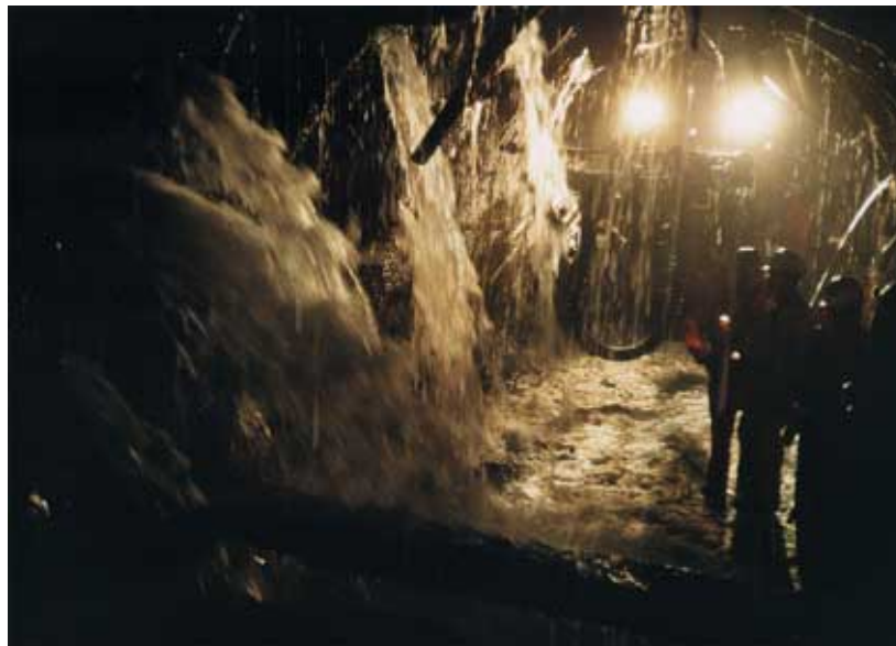
Abbildung 3: Massive Bergwasserzutritte beim Tunnelbau
