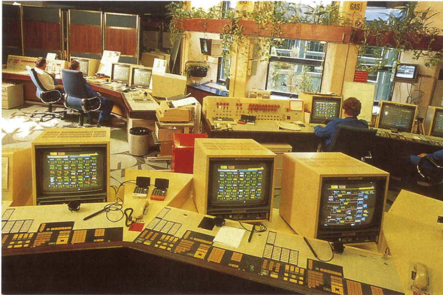
Abb. 211. Ausschnitt aus der zentralen Meßwarte der Raffinerie.
