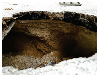
Abbildung 8: Erdfall 2018 in der Kröpfelsteigstraße 26
