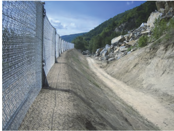
Schutzdamm mit Alarmzaun im April 2007
