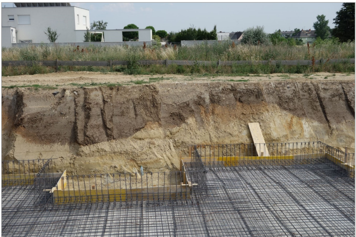
Abb. 2.2.2.13: Baugrube in Neusiedl am See: Wellig ausgebildeter dunkelbrauner Bodenhorizont im Hangenden unterlagert von Terrassenkiesen (Foto: M. Peresson).
