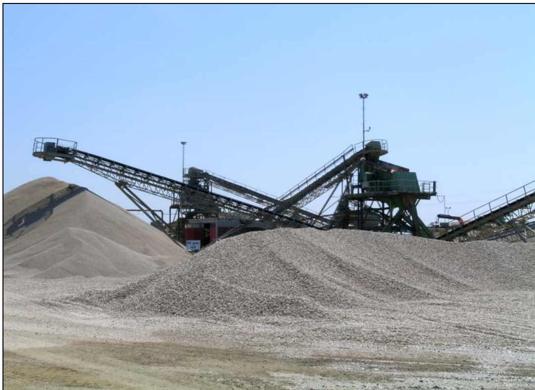
Abb. 111: Schotterwerk Holler, mobile Sieb- und Brecheranlage (02/08/2005)
